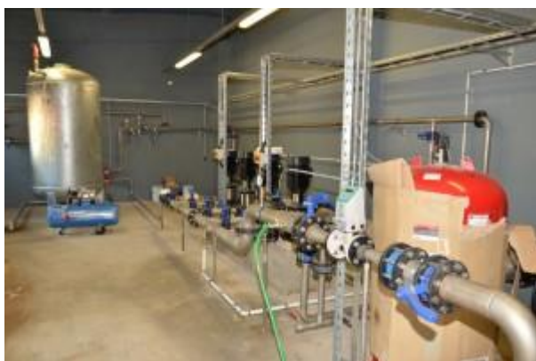
Foto 13. Päre puurkaev-pumpla sisseseade
